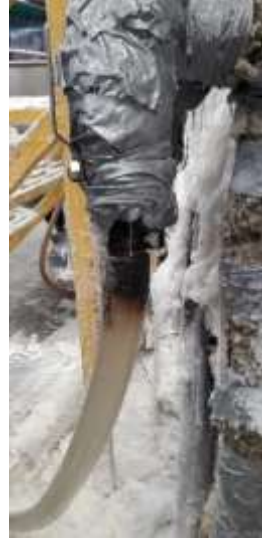
Ilustración 10 conexiones quemadas y desgastadas
