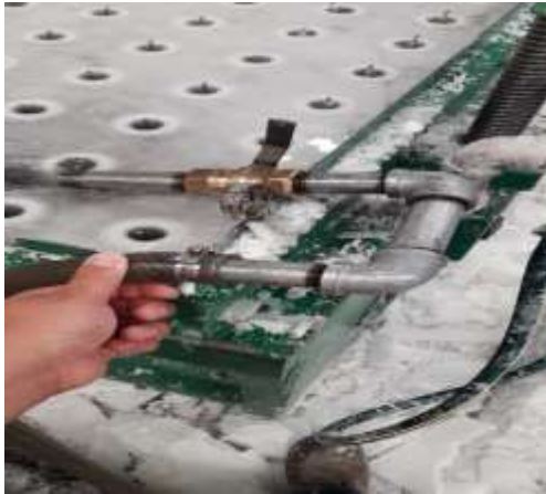
Ilustración 17 mal posición de la válvula con el sistema viejo
